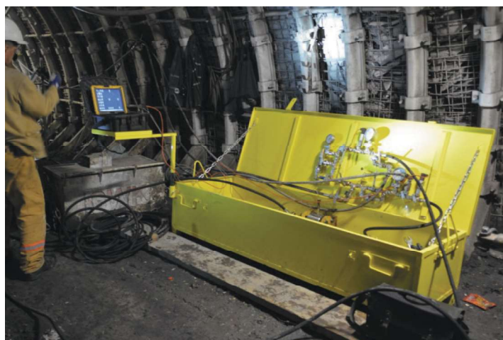
Rys. 6. Układ kontrolno-pomiarowy do NUHS po podłączeniu na poligonie badawczym
