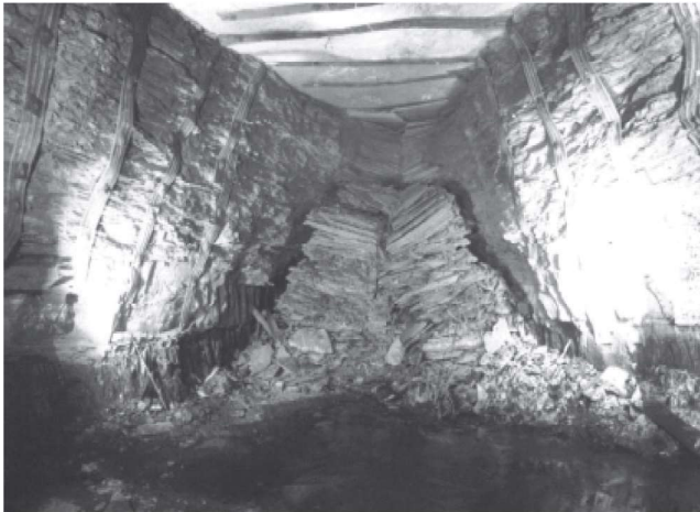
Rys. 1. Zawal stropu bezpośredniego na skutek działania znacznych obciążeń poziomych w kopalni White Pine, USA (Butra et al. 2011)
