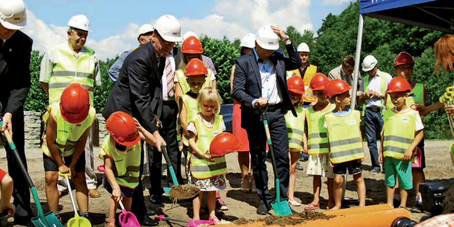
Zachelmie, 18 lipca 2013 r. Uroczyste wbicie łopaty pod budowę kanalizacji w gminie Zagnańsk
