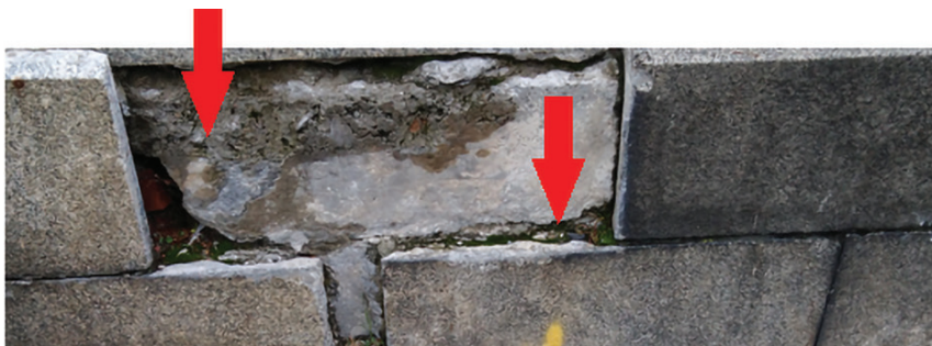
Fot. 2. Destrakcja cokołu. Odpadające okładziny wskutek wypłukania zaprawy klejącej. Czerwonymi strzałkami zaznaczone zostały miejsca zdegradowanej zaprawy (fot. O. Kopyłow)
