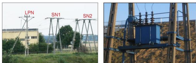
Rys. 1. Linia potrzeb nietrakcyjnych (LPN) zasilana dwoma liniami SN1 i SN2 oraz Transformator LPN (SN/0,4 kV) [5, 9]
