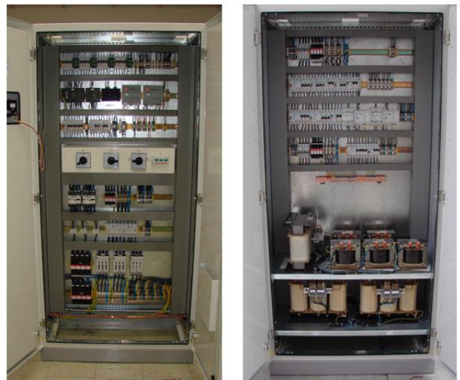
Rys. 8. Widok szafy przyłączeniowej TS oraz stojaka transformatorów STr systemu ELZAS [7]
