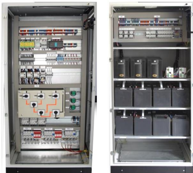
Rys. 10. Widok wnętrza Zintegrowanej Tablicy Zasilającej ZTZ z elementami automatyki oraz stojaka przetwornic Sp systemu SUZ-2M [4]
