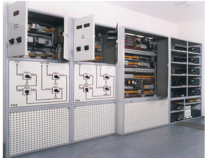
Rys. 5. Widok szaf wchodzących w skład systemu zasilania typu SZUS (KZA Kraków) [10]
