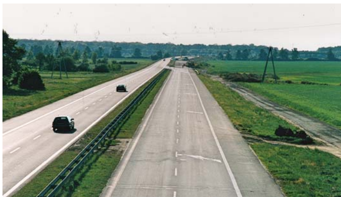
Fot. 1. Widok fragmentu spękaną jezdni północnej (prawa strona) ok. km 207, przed przebudową (fot. K. Jabłoński)
