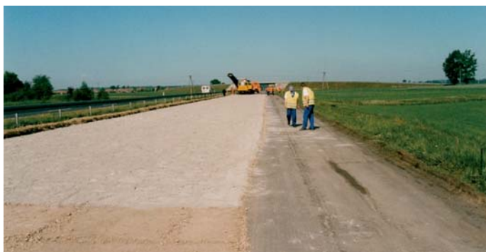
Fot. 2. Widok pierwszego odcinka próbnego przygotowanego do głębokiego recyklingu na miejscu (fot. K. Jabłoński)
