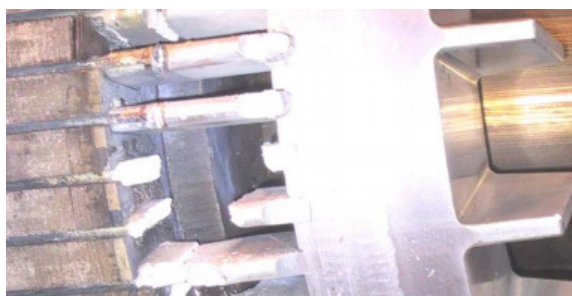
Rys. 10. Przykładowe uszkodzenie prętów klatki wirnika silnika 800 kW
