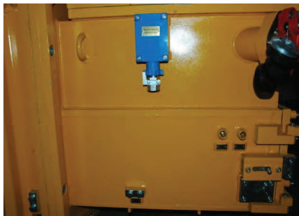
Rys. 5. Komora GN stacji transformatorowej – widok blokady mechanicznej i elektrycznej [2]
