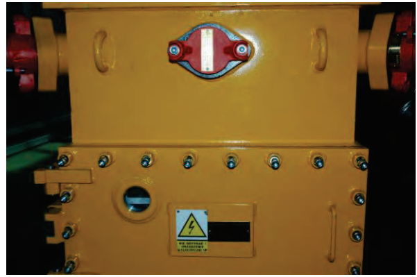
Rys. 7. Komora GN stacji transformatorowej [2]
