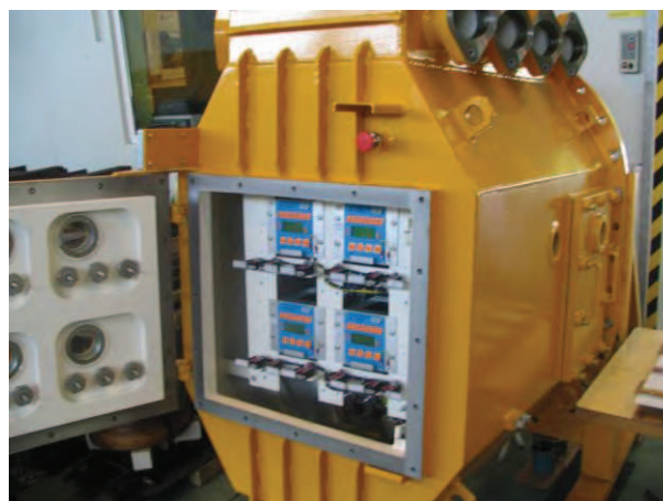
Rys. 3. Komora dolnego napięcia projektowanej stacji transformatorowej [2]
