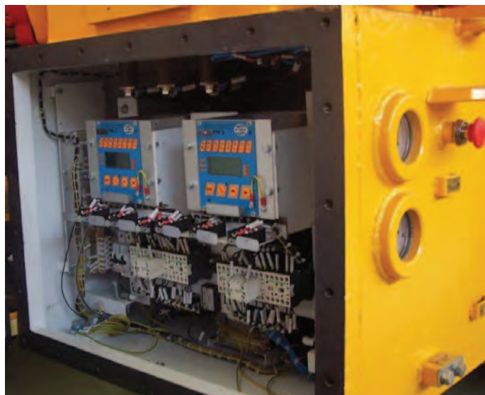
Rys. 12. Komora DN stacji transformatorowej – zabezpieczenia typu PM [2]
