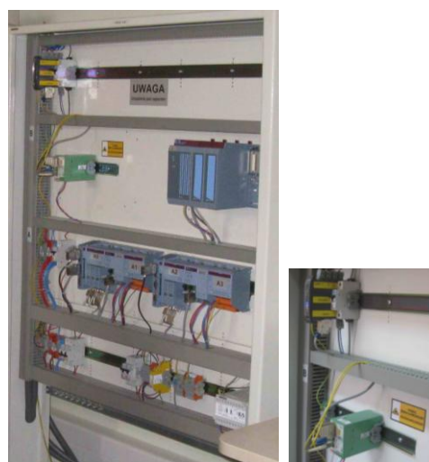
Rys. 5. Rozmieszczenie elementów i widok urządzeń SPS w Laboratorium Systemów SRK; widok układu do transmisji światłowodowej [4]
