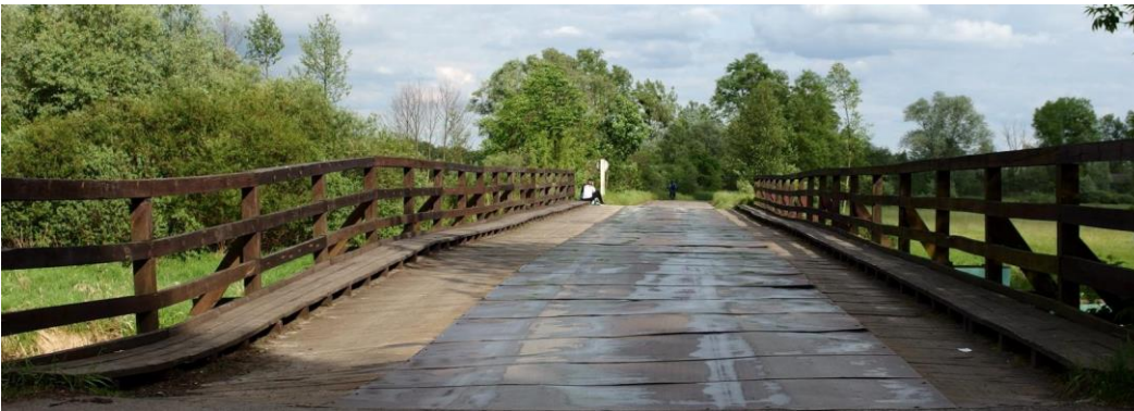
Fig. 8. The last wooden bridge in the middle Wieprz, in Milejów (dismantled in autumn 2016). Source: author Ryc. 8. Ostatni drewniany most na środkowym Wieprzu, w Milejowie (rozebrany jesienią 2016 r.). Źródło: autor
