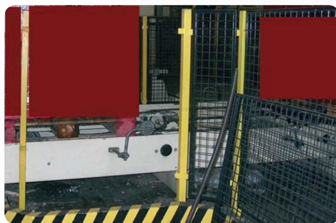
Fot. 2. Zdjęta osłona na zakręcie linii transportującej paczki z produktami Photo 2. A defeated guard on the curve of a transportation line of a finished product
