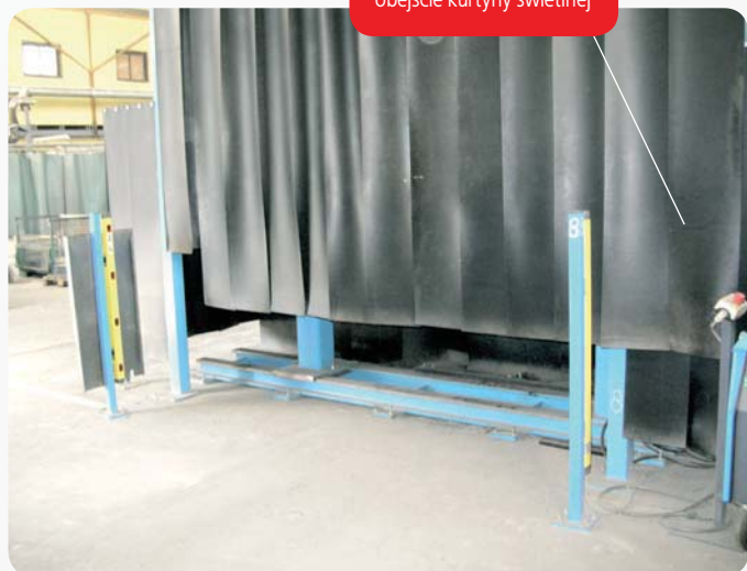
Fot. 3. Nieprawidłowo zainstalowana kurtyna świetlna Photo 3. Improperly installed focus light curtain
