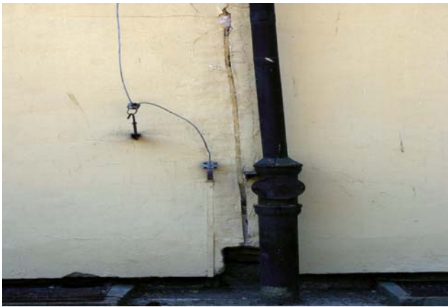
Ryc. 9. Pęknięcie dolnych partii muru i fundamentu budynku mieszkalnego w rejonie linii uskoku strefy Z2. Fot. L. J. Kaszubowski (lato, 2014) Fig. 9. Crack of the lower parts of the wall and the foundation of a residential building in the area of fault line zone Z2. Photo by L. J. Kaszubowski (summer, 2014)
