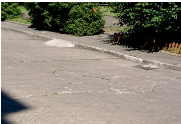
Ryc. 10. Bardzo mocno spękana nawierzchnia betonowa części parkingowej na obszarze strefy Z2. Fot. L. J. Kaszubowski (lato, 2014) Fig. 10. Very heavily cracked concrete surface of the part of parking in the area of zone Z2. Photo by L. J. Kaszubowski (summer, 2014)
