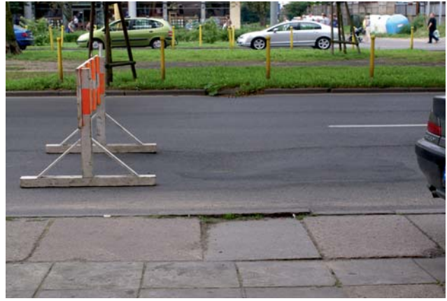
Ryc. 11. Awaria al. Bohaterów Warszawy w 2007 roku (Kaszubowski, 2011) w rejonie linii uskoku strefy Z3. Zapadająca się nawierzchnia asfaltowa ulicy. Fot. L. J. Kaszubowski (lato, 2007) Fig. 11. Damage of Bohaterów Warszawy Ave. in 2007 year (Kaszubowski, 2011) in the area of the fault line zone Z3. Collapsing of the asphalt surface of the street. Photo by L. J. Kaszubowski (summer, 2007)
