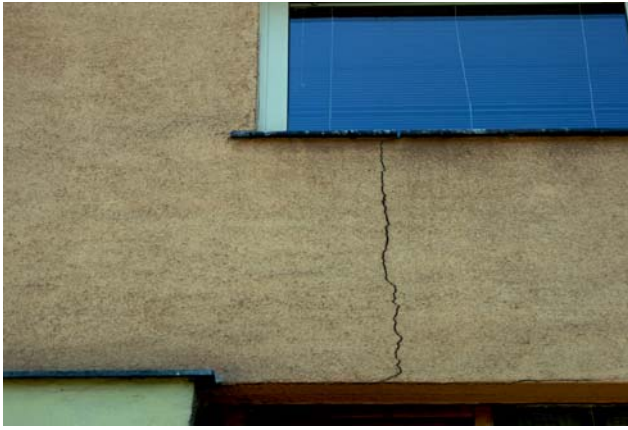
Ryc. 8. Pęknięcie muru budynku mieszkalnego w rejonie linii uskoku strefy Z2. Fot. L. J. Kaszubowski (lato, 2014) Fig. 8. Crack of the wall of a residential building in the area of the fault line zone Z2. Photo by L. J. Kaszubowski (summer, 2014)
