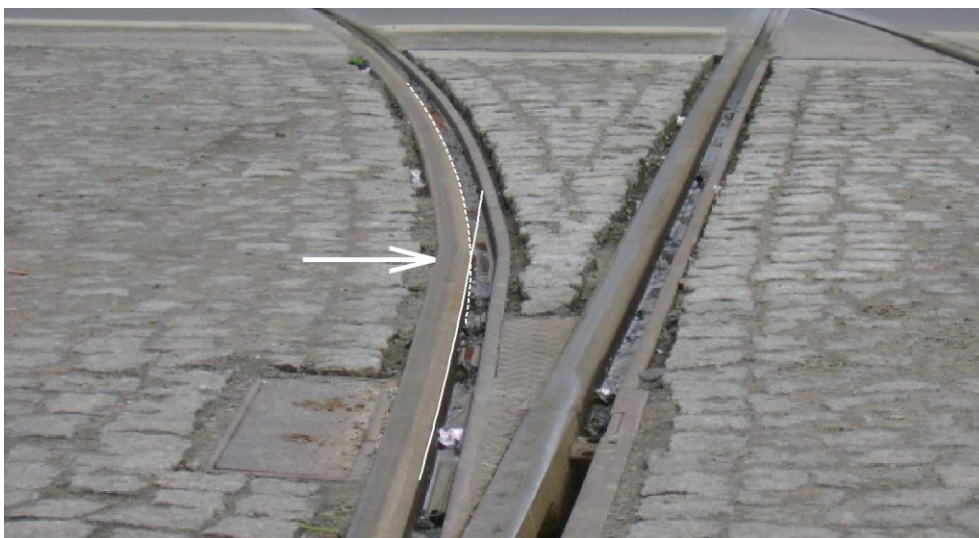
Rys. 1. Tramwajowa relacja skrzyżna z ul. Widok w ul. Kazimierza Wielkiego (zdjęcie wykonane zgodnie z kierunkiem ruchu) – miejsce występowania kantu w szynie wyróżniono białą poziomą strzałką, dodane na zdjęciu robocze białe linie (ciągła i przerywana) odzwierciedlają kształt krzywizny toku szynowego w planie
