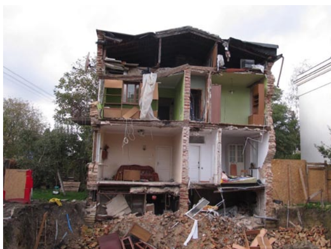
Rys. 8. Katastrofa budowlana w wyniku wykonania wykopu w bezpośrednim sąsiedztwie ściany szczytowej budynku
