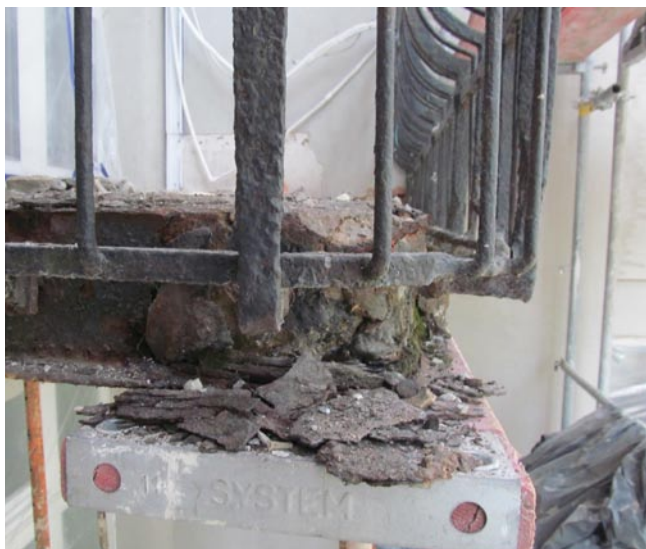
Rys. 4. Zużycie techniczne elementów konstrukcyjnych balkonu w budynku wielorodzinnym; silna korozja stalowych profili obwodowych oraz masywnej balustrady stanowiącej element konstrukcyjny płyty balkonowej
