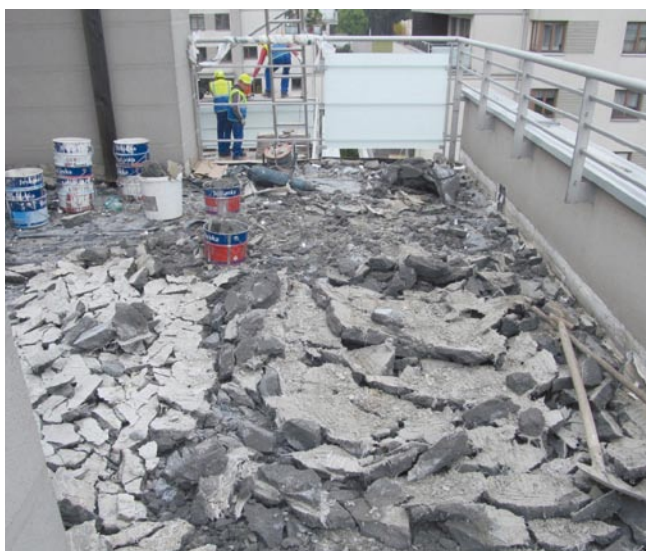
Rys. 5. Wady projektowe i wykonawcze w rozwiązaniu układu warstw tarasowych na osiedlu domów wielorodzinnych; brak paroizolacji, wadliwie wykończona strefa krawędziowa, wadliwie wykonana zespolona izolacja szlamowa, wadliwie wykonane obróbki blacharskie
