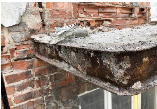
Rys. 6. Skutki wadliwego zakresu robót remontowych (przyjętego samowolnie przez wykonawcę – bez udziału projektanta – inżyniera budownictwa); skorodowane belki stalowe zostały zakryte styropianem (bez ich remontu czy zabezpieczenia antykorozyjnego), usterka odkryta po kilku latach od remontu balkonów – podczas robót renowacyjnych elewacji
