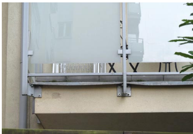
Rys. 7. Wady wykonawcze podczas wymiany balustrad balkonowych; podczas montażu marek balustradowych (w celu uzyskania wysokości balustrady 1,1 m) ponacinano obróbki blacharskie płyt balkonowych, po kilku latach od tego błędu – konieczny remont płyt balkonowych oraz elewacji budynku
