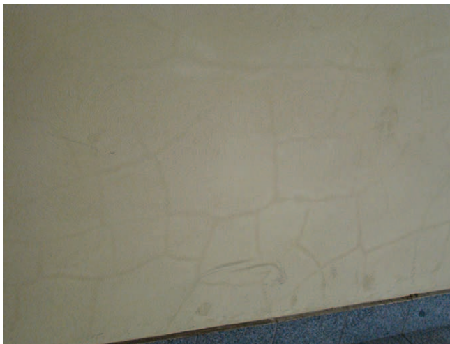
Rys. 4. Zarysowania wyprawy tynkarskiej ścian tunelu – typowa morfologia rys wywołanych skurczem tynku
