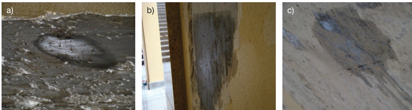
Rys. 3. Wynik zwilżania powierzchni (tzw. testu wody) na powierzchni elementów betonowych, z których odpadła wyprawa tynkarska: a) przekrycie (suffit), b) ściana tunelu oraz c) ściana pionowa obudowy wyjścia z tunelu (błyszcząca powierzchnia świadczy o występowaniu na powierzchni betonu warstwy hydrofobowej)
