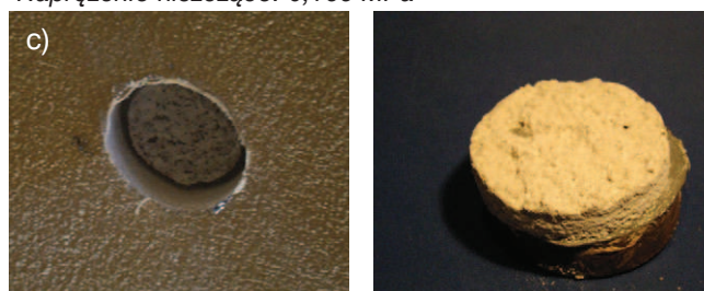
Mechanizm zniszczenia: 100% w tynku Napężenie niszczące: 0,172 MPa
