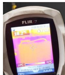
Rys. 13. Pomiar rozkładu temperatury w komorze baterii
