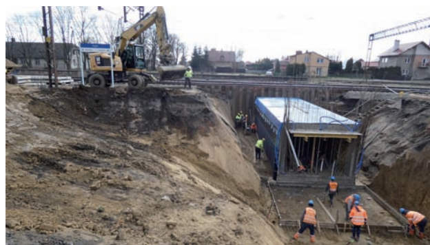
Rys. 20. Budowa tunelu na stacji Żurawica na LK 91 (1.04.2023 r.) [fot. A. Mirek / PLK]
