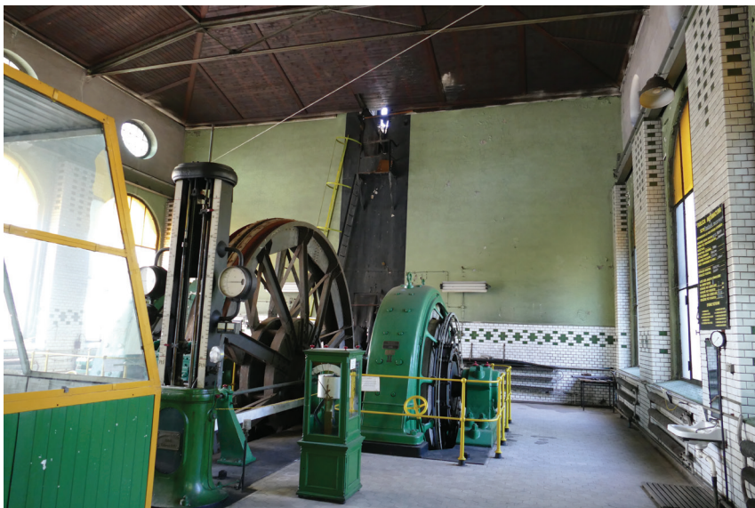
Fot. 4. Pomieszczenie maszynowni Szybu Poniatowski było inwentaryzowane przy użyciu skanera 3D. Fot. arch. aut., 2019
