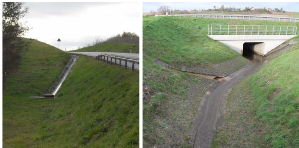
Rys. 2. Dopływ ścieków opadowych z odwodnienia drogi krajowej nr 4 (na lewo) i odpływ oczyszczonych ścieków (na prawo) ze zbiornika retencyjnego nr 46 [fot. B. Wiśniowska-Kielian]
