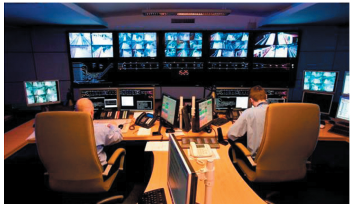
Fot. 5. Centralna dyspozytornia
