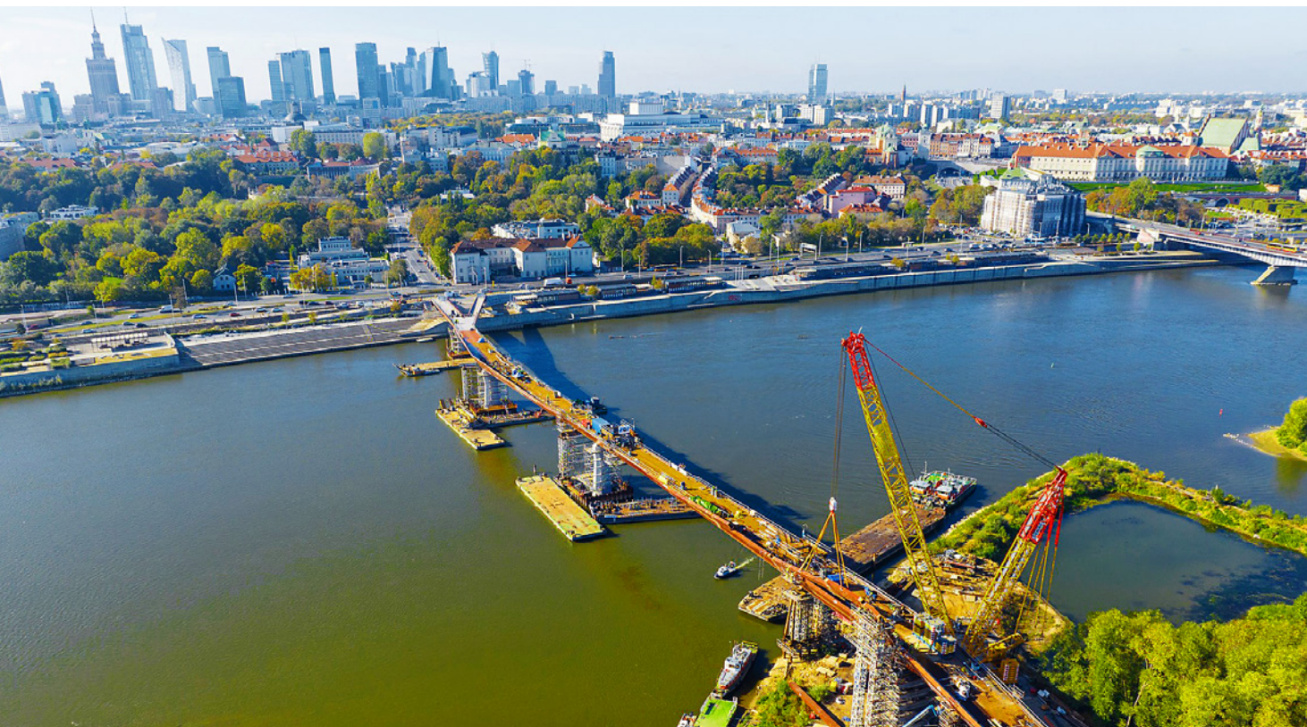
W 2024 r. zaplanowano oddanie do użytku mostu Nadwiślańskiego w Warszawie. Most pieszo-rowerowy poza swoją oczywistą funkcją będzie cechował się również walorami rekreacyjnymi, fot. Urząd Miasta Stołecznego Warszawy
