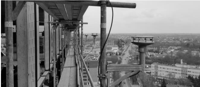
Rys. 4. Anemometry 2D zamontowane na zewnątrz rusztowania Fig. 4. 2D anemometers mounted on the outer façade of scaffolding
