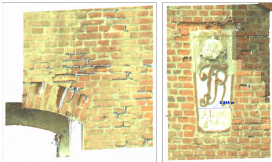
Ryc. 4. Fragment muru z widocznymi ubytkami (po lewej) i zwornik (po prawej) nad wejściem do budynku studni. Korespondujące fragmenty zaznaczono na rycinie 3
