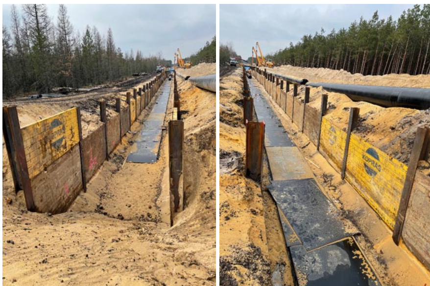
Rys. 4. Gazociąg Pogórska Wola-Pałęcznica to inwestycja o długości łącznej ok. 78 km; wykop zabezpieczono ściankami słupowo-płytowymi [12]
