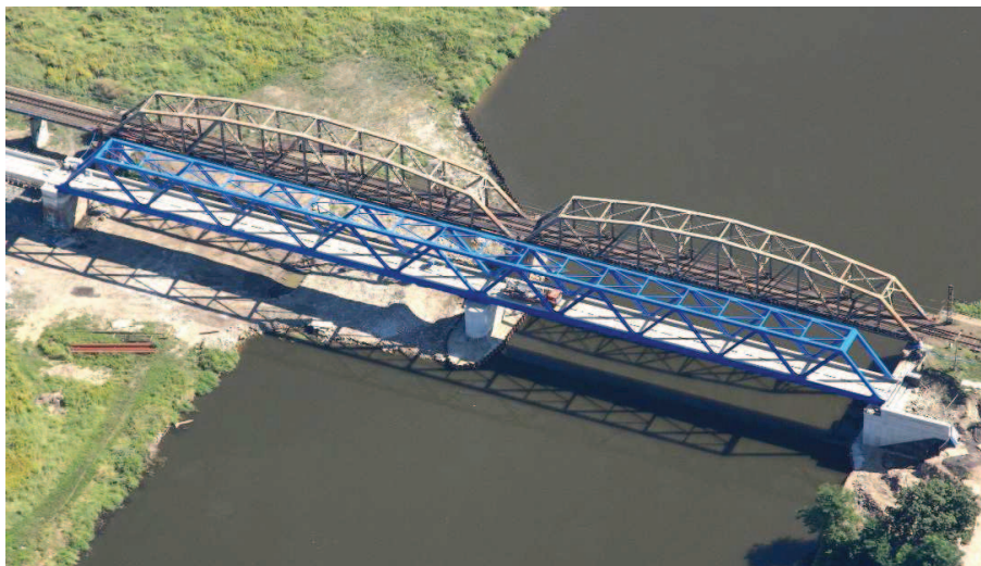
Rys. 5. Most nad Odrą we Wrocławiu. Nowa konstrukcja w torze nr 2 po nasunięciu w położenie docelowe / istniejąca konstrukcja w torze nr 1 (przed przebudową)
