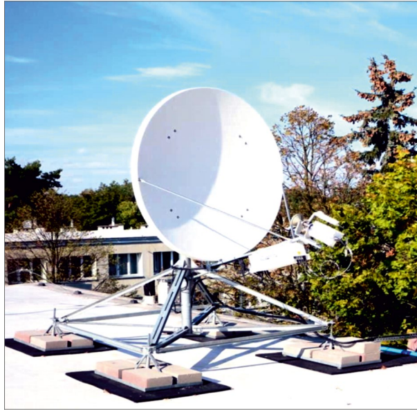
Rys. 10. Antena nadawczo-odbiorcza zestawu TWSTFT do porównań polskiego czasu urzędowego UTC(PL) zainstalowana w IŁ
