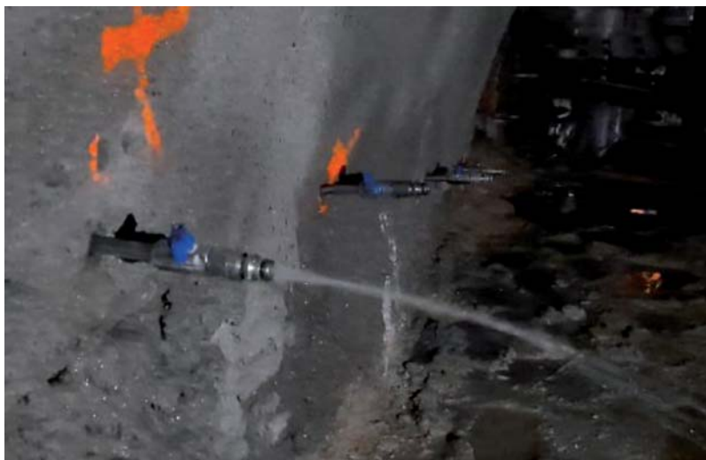
Fot. 5. Pakery iniekcyjne z otwartymi zaworami. Widoczny jest charakterystyczny wyciek wody pod ciśnieniem napierającej na ścianę czołową komory startowej. Po osadzeniu pakerów w momencie otwarcia zaworu zwrotnego woda wydostawała się w dużych ilościach jak z przysłowiowego kranu. Takie zjawisko widoczne było na wszystkich pakerach w pierwszym etapie iniekcji, przy czym w części górnej obserwowano niższe ciśnienie
