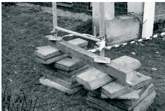
Rys. 1. Błędnie wykonane posadowienia rusztowania (Fot. Peri Polska)
