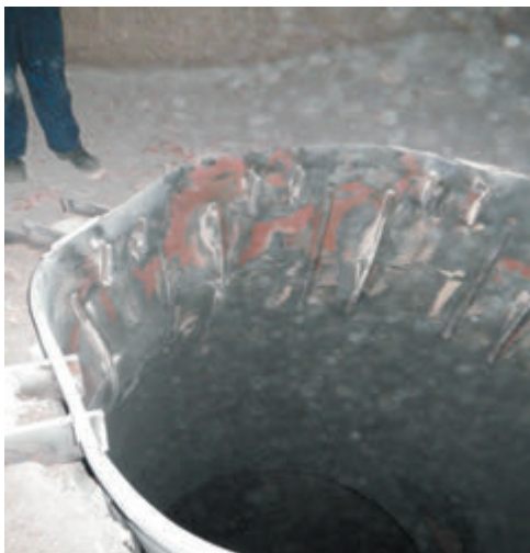
Rys. 1. Degradacja geometryczna nurnika bloku energetycznego
