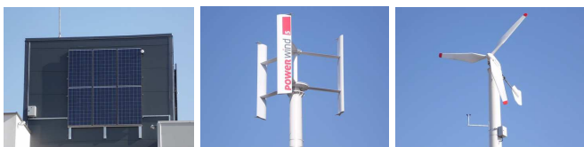
Rys. 1. Elektrownia hybrydowa na terenie kampusu Politechniki Białostockiej
