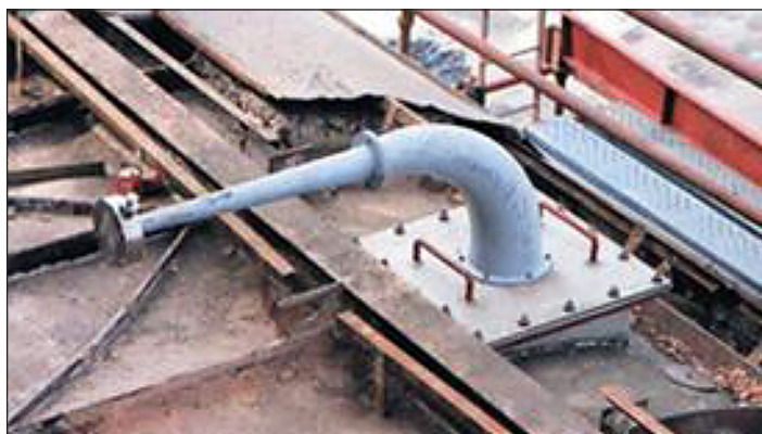
Rys. 6. Trąbka akustyczna na dachu elektrofiltru [18]
