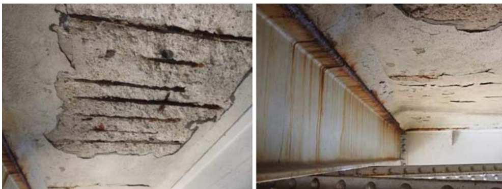
Fot. 4. Odspojenie betonowej otuliny z korozją prętów zbrojeniowych oraz korozją rusztu pomostu [8]
