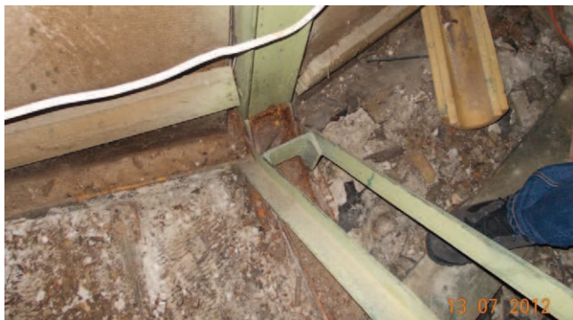
Rys. 10. Spodek dolny – korozja węzła dolnego kratownicy, połączenie z pierścieniem środkowym
