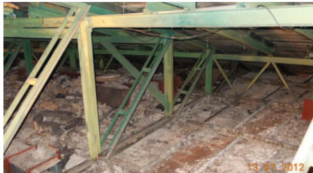
Rys. 11. Spodek dolny – widok na dźwigar kratowy, pas dolny usztywniony rusztem z kratą
