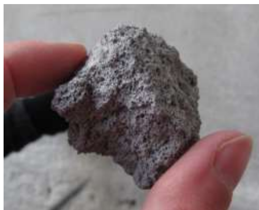
Fot. nr 6 – Widok odkutego fragmentu masy pianobetonu- lekkiego materiału wypełniającego stanowiącego funkcję docieplenia
