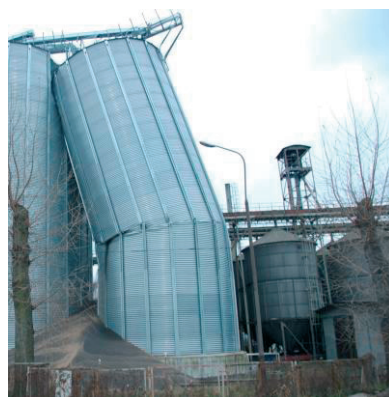
Rys. 2. Awaria stalowego silosu na zboże
