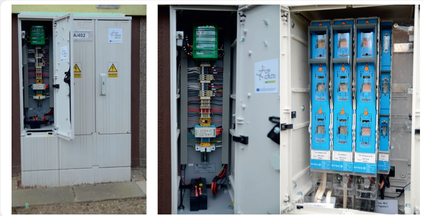
Fot. 2. Złącza kablowe nN z monitorowaniem
