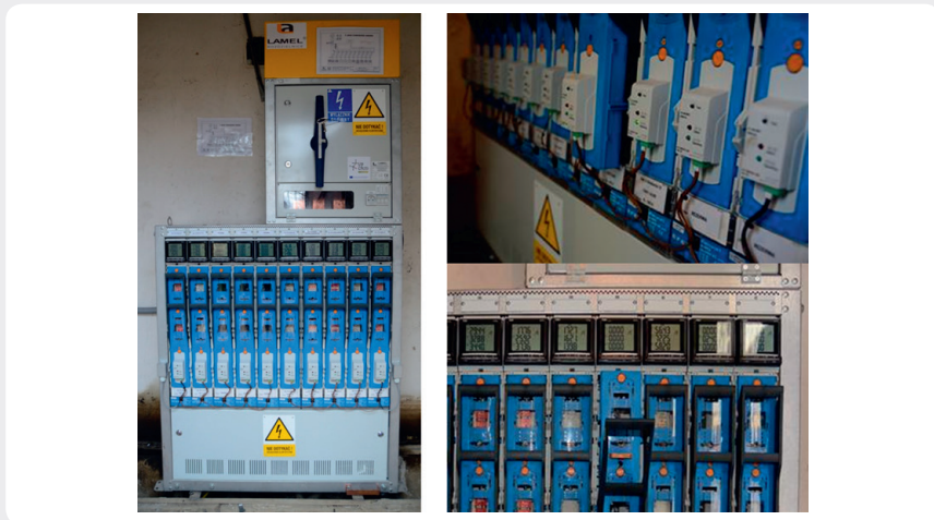
Fot. 1. Rozdzielnica nN z monitorowaniem poszczególnych obwodów nN
