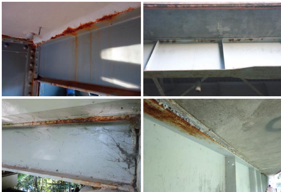
Rys. 6. Przykłady korozji strefy zespolenia w mostach zespolonych na skutek przecieków wody opadowej
