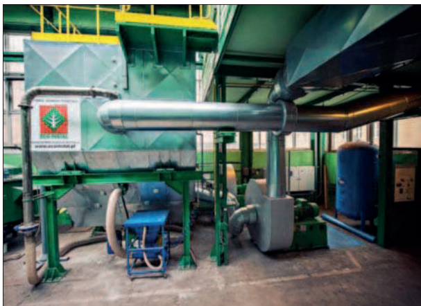
Rys. 8. Instalacja odciągu i odpylania gazów poreakcyjnych
