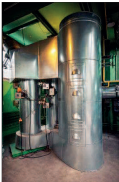
Rys. 9. Instalacja ATON MOS do neutralizacji gazów odlotowych z linii spiekania
