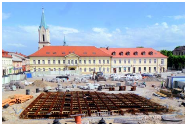
Ryc. 11. Oświęcim. Rynek Główny. Końcowy etap prac rewitalizacyjnych na terenie centrum Starego Miasta, 2014 r. Montaż konstrukcji żelbetowej płyty nad relikdami ratusza, 2014 r. Fig. 11. Oświęcim. Main Square. The final stage of revitalisation work in the centre of the Old Town, 2014. Mounting the ferroconcrete construction of the plate over the town hall relics, 2014
