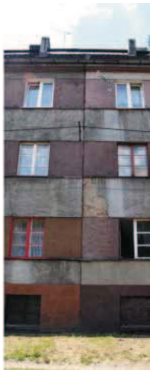
Rys. 5. Szereg „b” - zacięnięta dylatacja pomiędzy segmentami nr 2÷4 a 6÷8 – elewacja wschodnia
