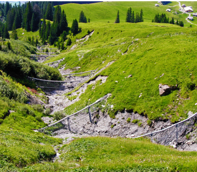
Układ barier elastycznych zainstalowanych w korycie potoku, w którym okresowo pojawiają się spływy gruzowe
