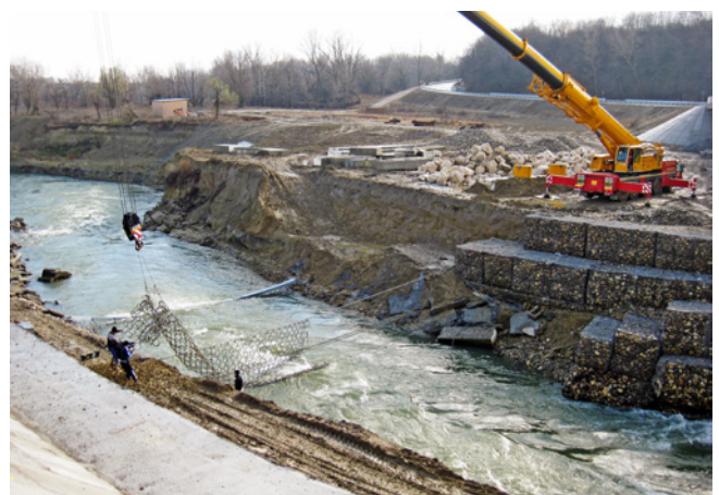
Przykład stabilizacji koryta w sąsiedztwie mostu – ochrona filarów mostu przez zastosowanie elastycznych barier przeciwrumowiskowych
