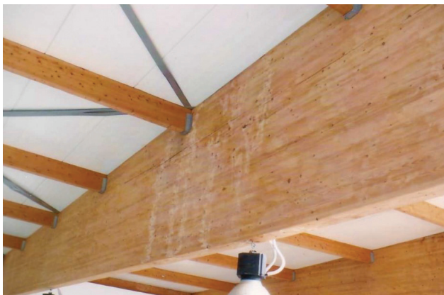
Fot. 3. Stężenie wiatrowe oraz zacieki na dźwigarach
