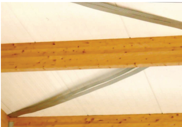
Fot. 4. Stężenie wiatrowe z widocznym zwisem
