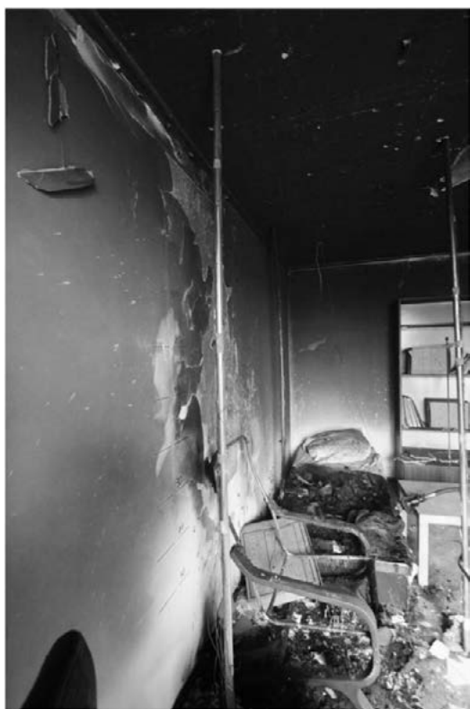
Ryc. 15. Widok miejsca pożaru w mieszkaniu doszczelnionym – po wykonaniu testu pożarowego
