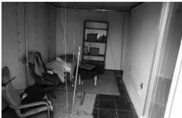
Ryc. 14. Widok miejsca pożaru w mieszkaniu doszczelnionym – przed wykonaniem testu pożarowego.
