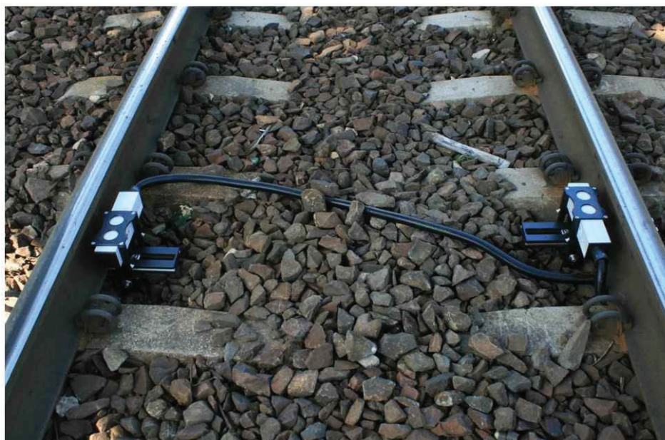
Rys.1. Anteny pomiarowe typu MFS-3D-100 zainstalowane w torze
