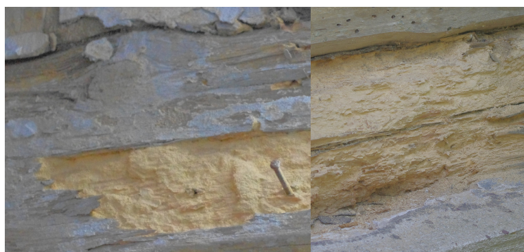
Rys. 5. Skutki żerowania owadów na powierzchni wewnętrznej ściany i na przyciesi (fot. B. Ordon-Beska)
