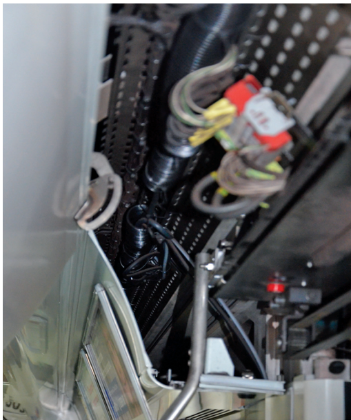
Rys. 3. Umieszczenie okablowania w pojazdach metra
