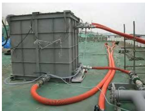
Fot. 1. Zbiornik dekontaminacyjny. Kanał wlotowy (Nuclear Engineering International www.neimagazine.com )
