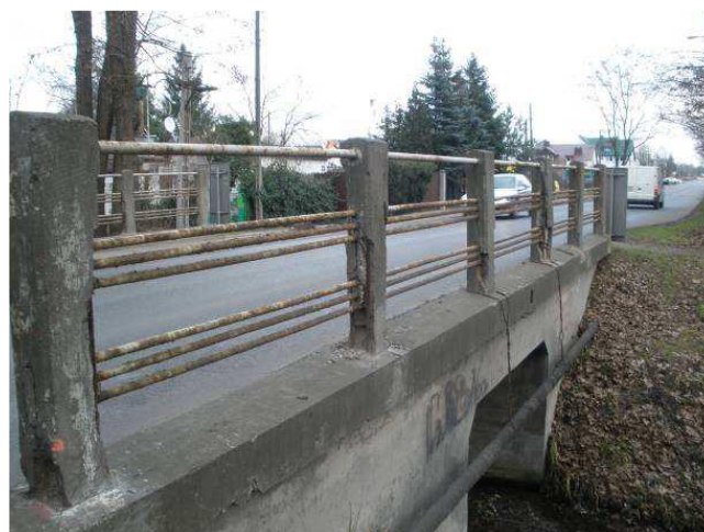
Rys. 6. Widok skorodowanej bariery na moście (fot. z pracy [8])
