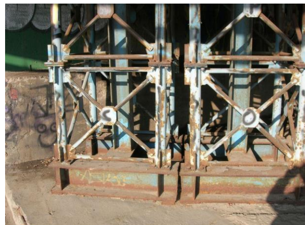
Rys. 1. Widok skorodowanych tymczasowych podpór kratowych wiaduktu potwierdzający różne tempa korozji obiektu (fot. własna)
