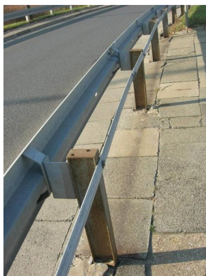
Rys. 5. Widok bariery drogowej z globalnie skorodowanymi słupkami podporowymi (fot. własna)
