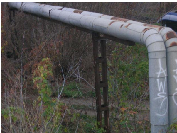
Rys. 3. Widok globalnie skorodowanej konstrukcji wsporczej rurociągu skorodowanego lokalnie (fot. własna)
