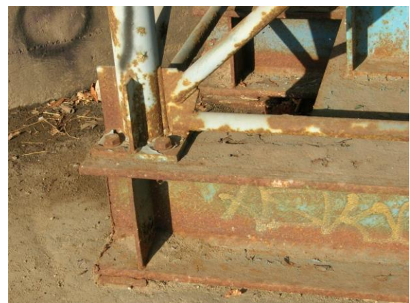
Rys. 2. Widok dolnego, najbardziej lokalnie skorodowanego, węzła tymczasowej podpory kratowej wiaduktu (fot. własna)
