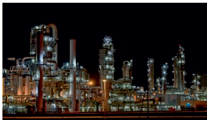
Fot. 4. Instalacja destylacji rurowo-wieżowej (DRW)
