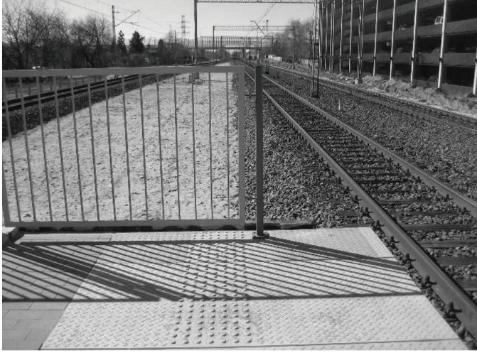
Fot. 3. Zabezpieczenie końca peronu (2)
