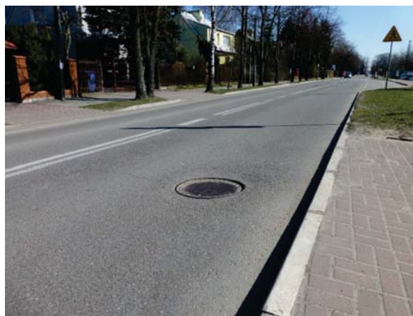
Fot. 2. Zapadnięty właz studni
