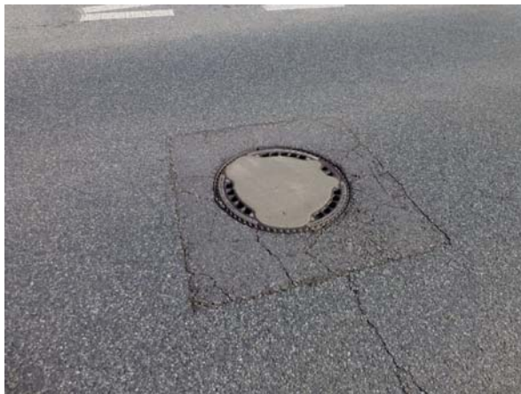
Fot. 3. Spękana nawierzchnia wokół wjazdu
