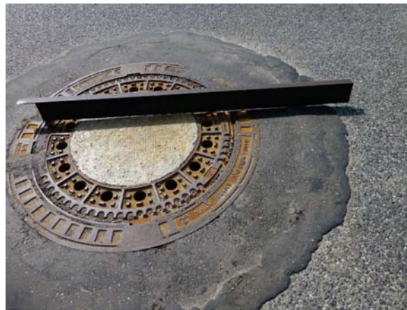
Fot. 4. Właz wystający z jezdni po korekcie
